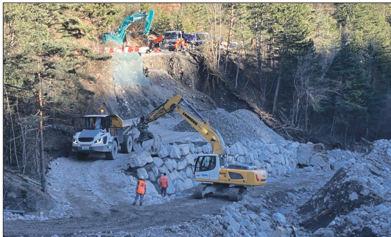
Réallon était inaccessible par la route durant une dizaine de jours en décembre. Le rétablissement par le Département a nécessité des travaux importants.
