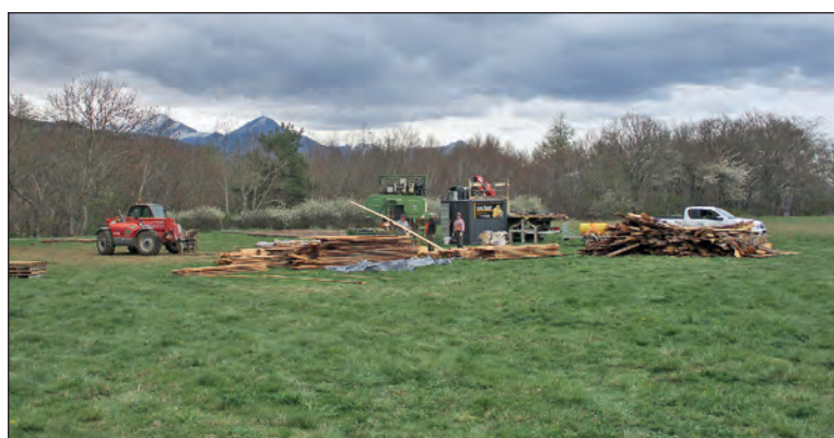
L'intervention de la scie mobile a permis de réaliser les éléments nécessaires à la réalisation d'une terrasse en mélèze pour le propriétaire de la parcelle.
